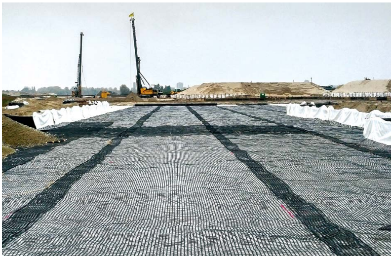
Figuur 14 – Het uitrollen van de geokunststofwapening voor het paalmatras Knooppunt Hofvliet West.
